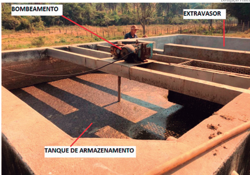
| Tanque de armazenamento do efluente.
